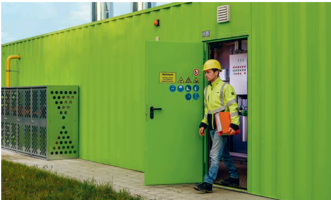
Michael Junghardt, Wärme- und Energielösungen, in der Energiezentrale. Von hier aus wird die Wärme verteilt.
